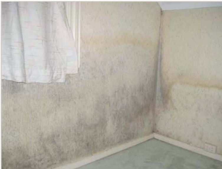
Figur 15. Foto: Kai Gustavsen. Rom uten isolasjon og fuktsperre etter bruk.
